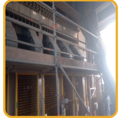
▲ Pasarela para mantenimientos de feeders.
